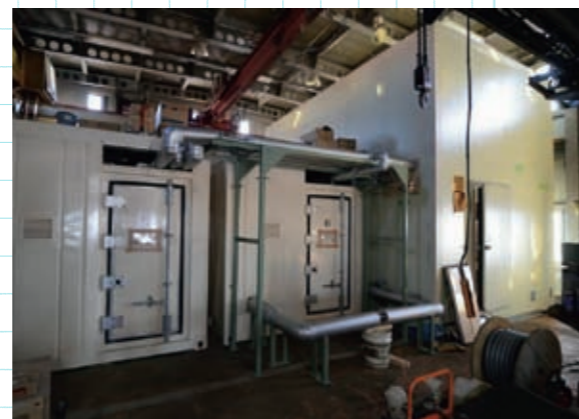
新しい汚水処理装置 3つの箱に収められコンパクトにまとまっている。それぞれの箱の中だけが暖房されており、建物全体は外気温とほぼ同じ。
